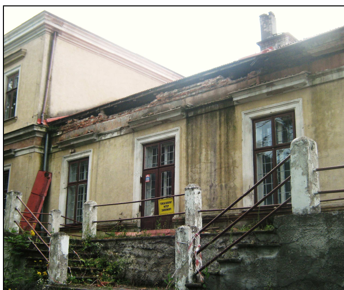
Uszkodzony gzyms w elewacji ogrodowej.
