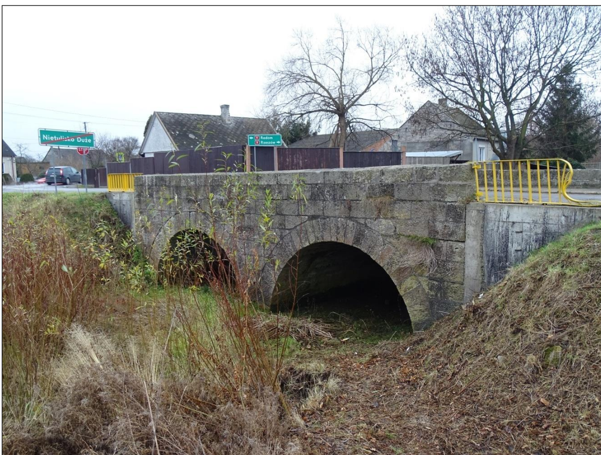
Most na kanale rzeki Kamiennej z 1932 r., postawiony na miejscu drewnianego mostu
